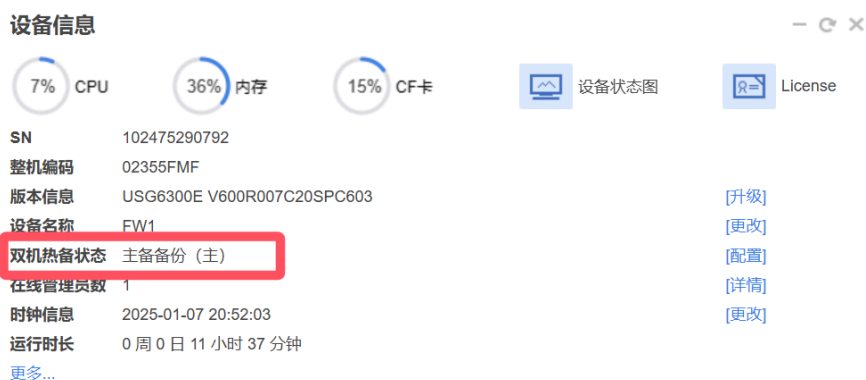
Figure 6: 防火墙双机热备（主，FW1）
